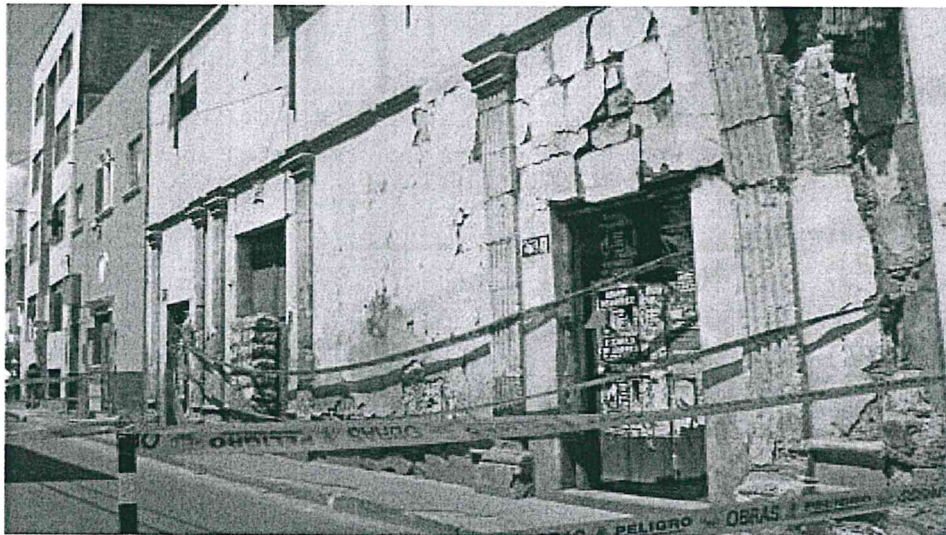
Figura 17. Viviendas en estado ruinoso centro de Lima (Fuente: Diario El Comercio, 2014)
