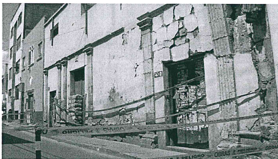
Figura 18. Viviendas en estado ruinoso en el centro de Lima
